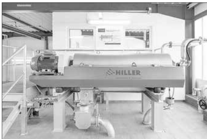
Die Kläranlage Leinetal wird eine neue Zentrifuge erhalten, die den Klärschlamm noch effizienter entwässert.
